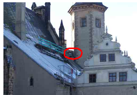
Angebrachter Dohlenkasten auf der Schlosskirche zu Altenburg
